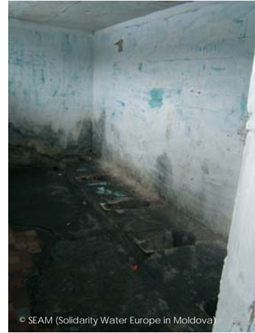
Toilettes du lycée de Vorniceni avant le projet
